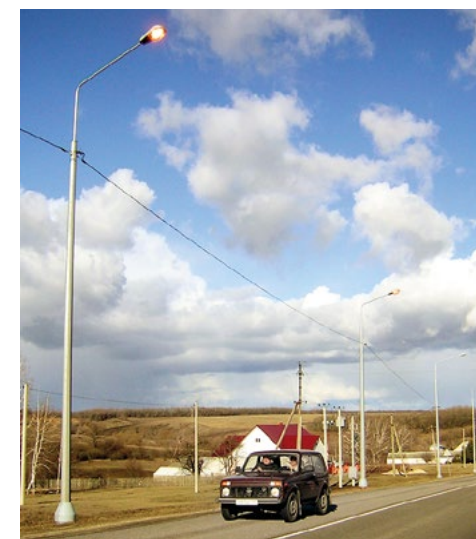
Искусственное электросвечение на автомобильной дороге Р-119 Орел – Ливны – Елец – Липецк – Тамбов
